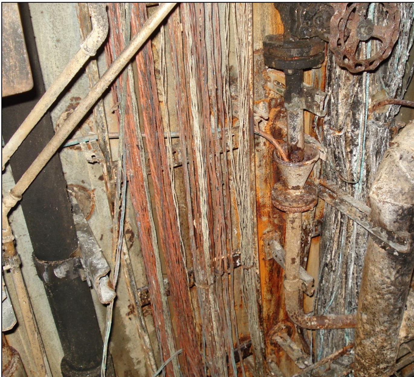
C6 - Nappe de câbles à proximité du DG4 Bunched cables near the DG4
